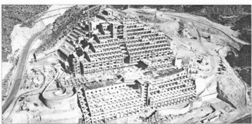
■ Vista del hotel que se construye junto a la playa de El Algarrobico en Carboneras. (MIRN FOTOGRAFIA AEREA)
